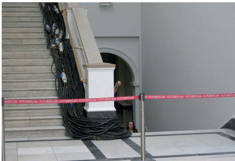
Kablage på Victoria and Albert Museum, London. Låt sakkunniga dra kablar i vandringsutställningar, för att undvika överhettning och snubbelrisk. Foto: Mathias Strömer.
